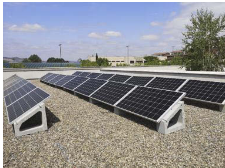
Paneles fotovoltaicos en la azotea del consultorio médico. / EL DÍA
